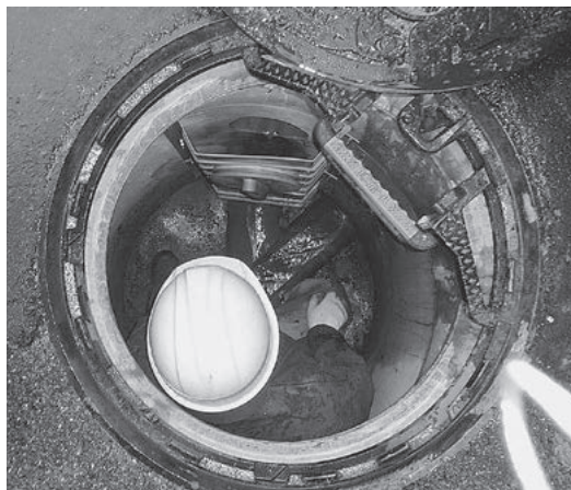
●1号マンホール
