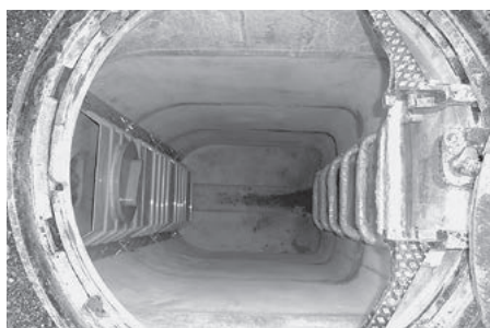
●A1マンホール
