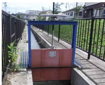
設置から約10年経過したFFU製ゲート
