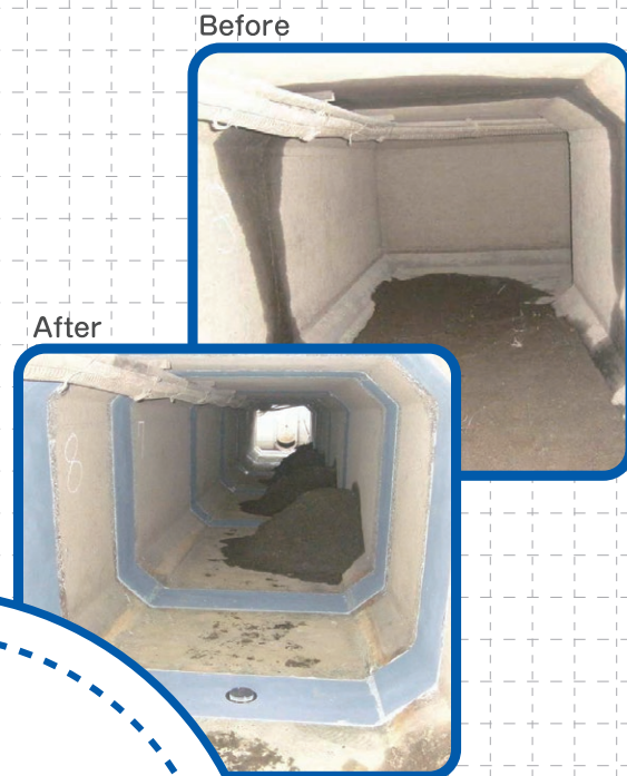
用水路ボックス目地補修工事 (処理用ウィーブホール装着)
