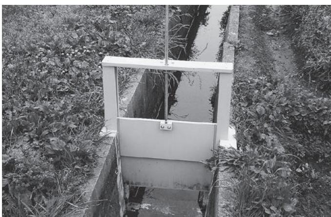
● 水位調整ゲート
