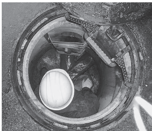
●1号マンホール
